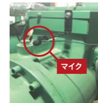
ターミナルボックスにL字金具を固定しL字金具先端にマイクを結束バンドで固定
