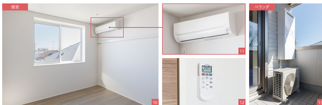
10 11 12 寝室や子ども部屋にはコンパクトな「ルームエアコン 白くまくん A」シリーズを採用。よく使う機能がワンボタンで見やすいリモコン。13 個室のエアコンと接続した室外機はベランダの反対側に。14 「創エネ」のための太陽光パネルは屋上に設置。（工事中の写真）
