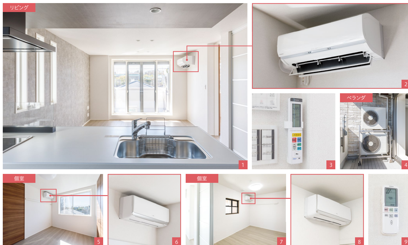
1 2 3 3LDKの開放的なリビングに馴染む「ルームエアコン 白くまくん Z」シリーズ。持ちやすく使いやすいスリムリモコン。操作内容などを音声でお知らせ。4 ベランダにすっきり収まる「2部屋用システムマルチエアコン」の室外機（上）と、リビングの「ルームエアコン 白くまくん Z」シリーズの室外機（下）。5 6 7 8 9 リビングと接する2つの個室には「2部屋用システムマルチエアコン：壁掛タイプ」を採用。室外機1台で室内機2台の個別運転が可能。入り口付近にリモコンを設置。
