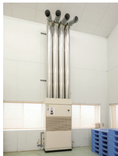
滅菌処理棟内製品置き場に設置された 業務用・産業用除湿機
