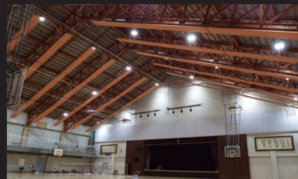
体育館など福利施設の天井照明
