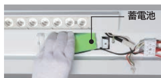
蓄電池を交換します。
