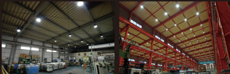
工場内や製品保管倉庫の天井照明
