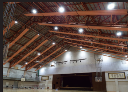
体育館など福利施設の天井照明
