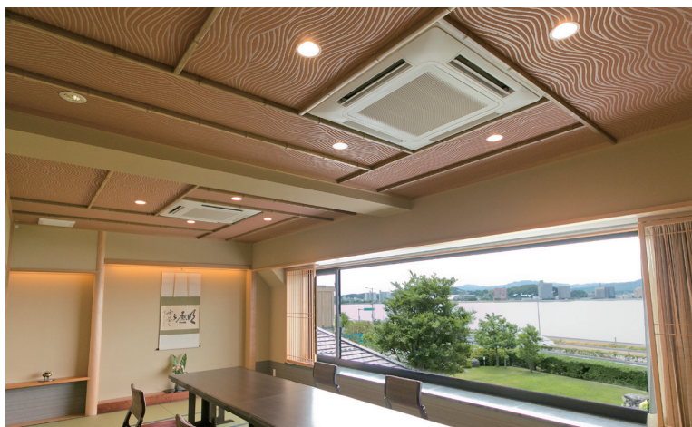
設計段階から施工プランを練り、客室の天井の枠内に美しく配置された「てんかせ4方向」。
